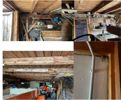
Offene Kabel Leuchten
